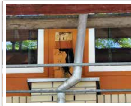
Die Fachwerkknoten der Hallenbinder sind durch Innenfäule geschädigt.
